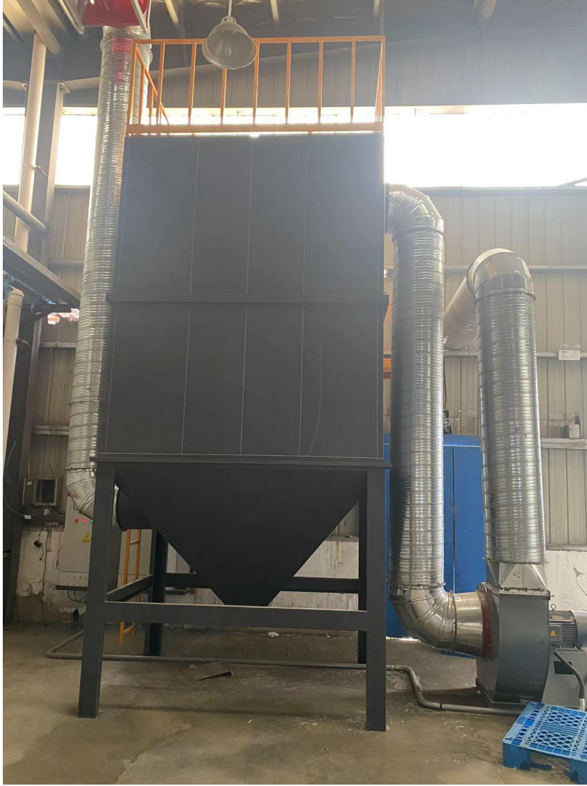
布袋除尘+15m 高排气 筒 DA001
